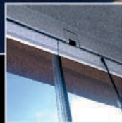
Sin guías sobresalientes
